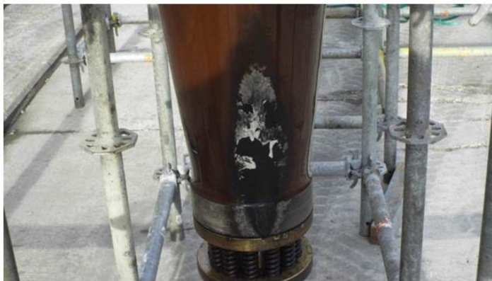
Durchführung 1V, Unterteil mit Entladungsspuren
