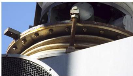
Kompensator an 1V beschädigt
