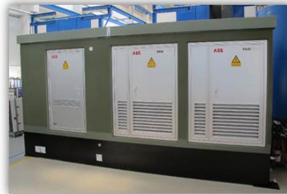
[ABB Brilon, Mittelspannungslängsregler 20 kV / 8 MVA]
