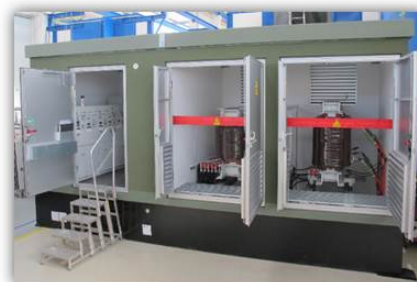
[ABB Brilon, Mittelspannungslängsregler 20 kV / 8 MVA]
